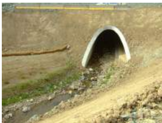
Crédit photo : Cerema Passage inférieur mixte (ouvrage de franchissement hydraulique avec aménagement d'une banquette pour la faune)
