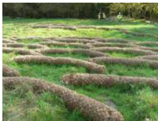
Crédit photo : Cerema Dispositif préventif de lutte contre une pollution : boudins "coco" jouant un rôle de filtre temporaire
