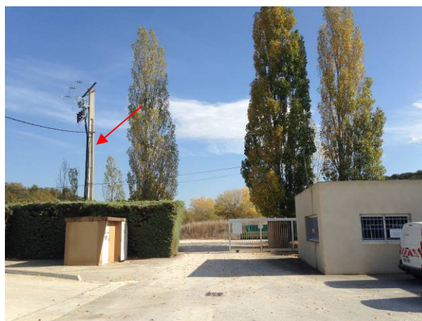
Figure 6. Arrivée électrique sur la station
