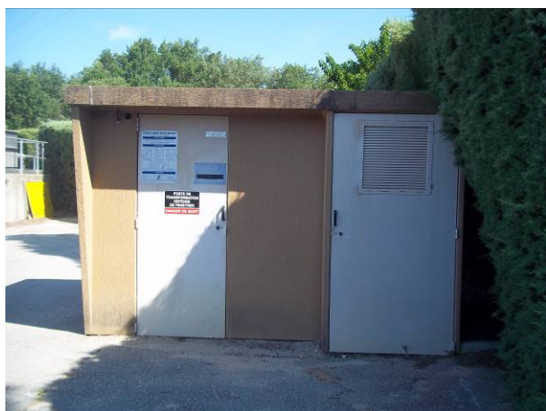
Figure 5. Transformateur entrée usine
